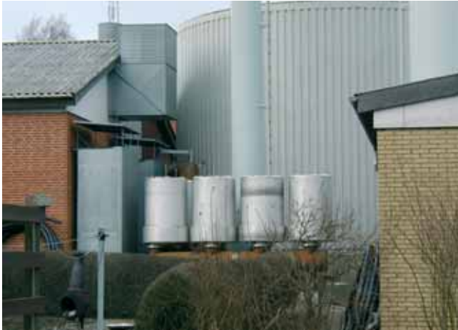
Figur 4. Foto af Reccat-anlægget hos Rask Mølle Varmeværk før isolering af reaktorer
