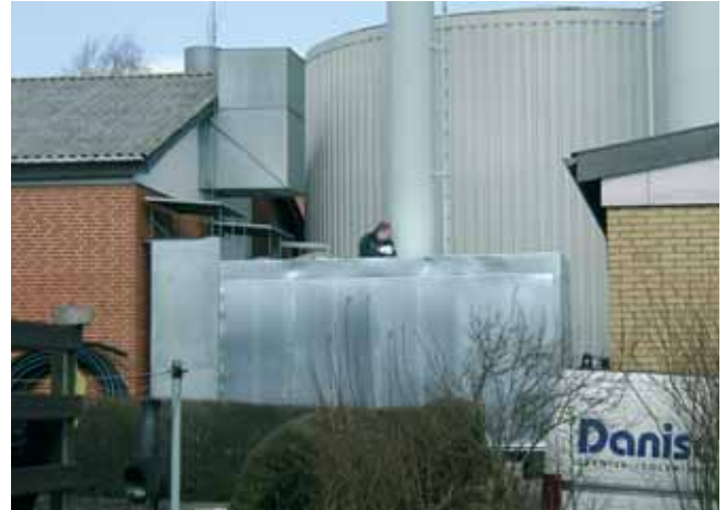
Figur 5. Foto af Reccat-anlægget hos Rask Mølle Varmeværk efter isolering af reaktorer
